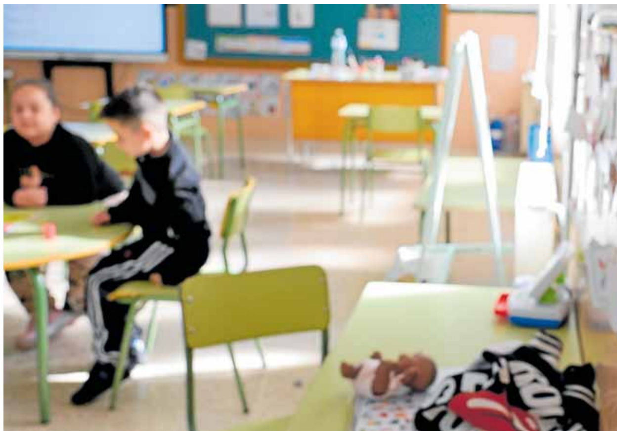
Una de las aulas del colegio Salzillo, en Espinardo, afectada por desperfectos en una de las paredes, en una imagen
