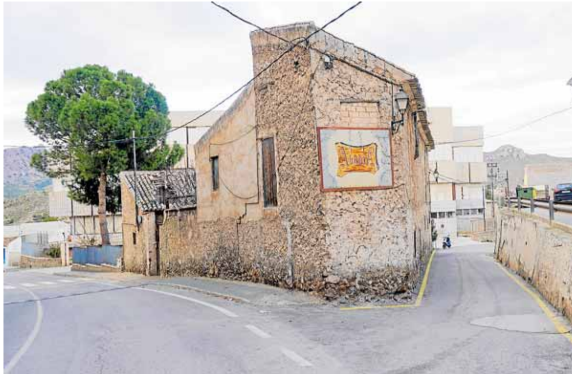
Inmueble que será derruido, en una intersección del casco urbano de Abarán. JUAN A. MORENO
