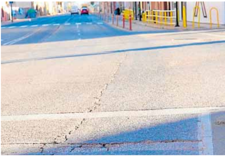
Imagen de algunos de los desperfectos de la vía. PSOE
