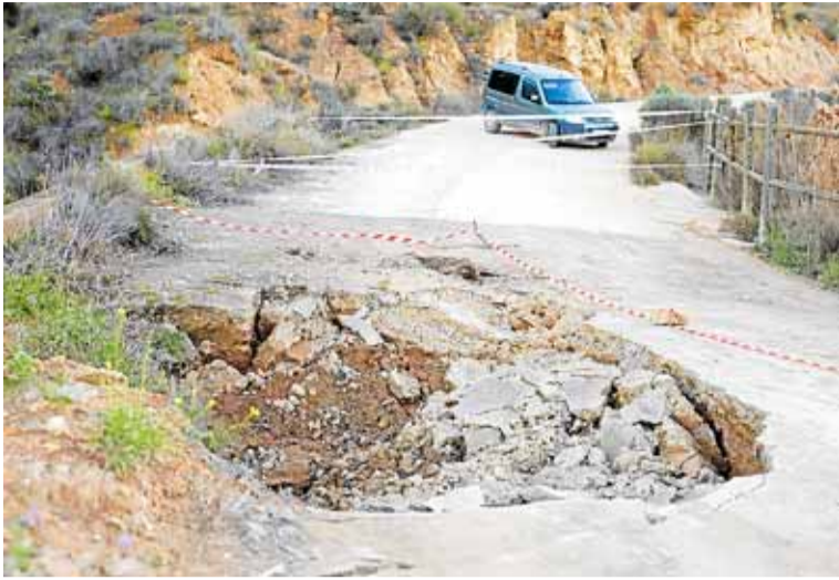
Socavón abierto por la lluvia en el Camino de los Pérez. NACHO GARCÍA
