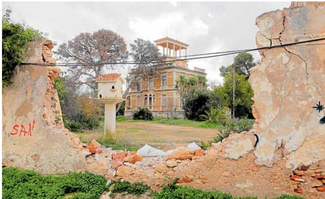
Estado del muro perimetral de la finca en una imagen tomada en el mes de diciembre. PEDRO MARTÍNEZ / AGM
