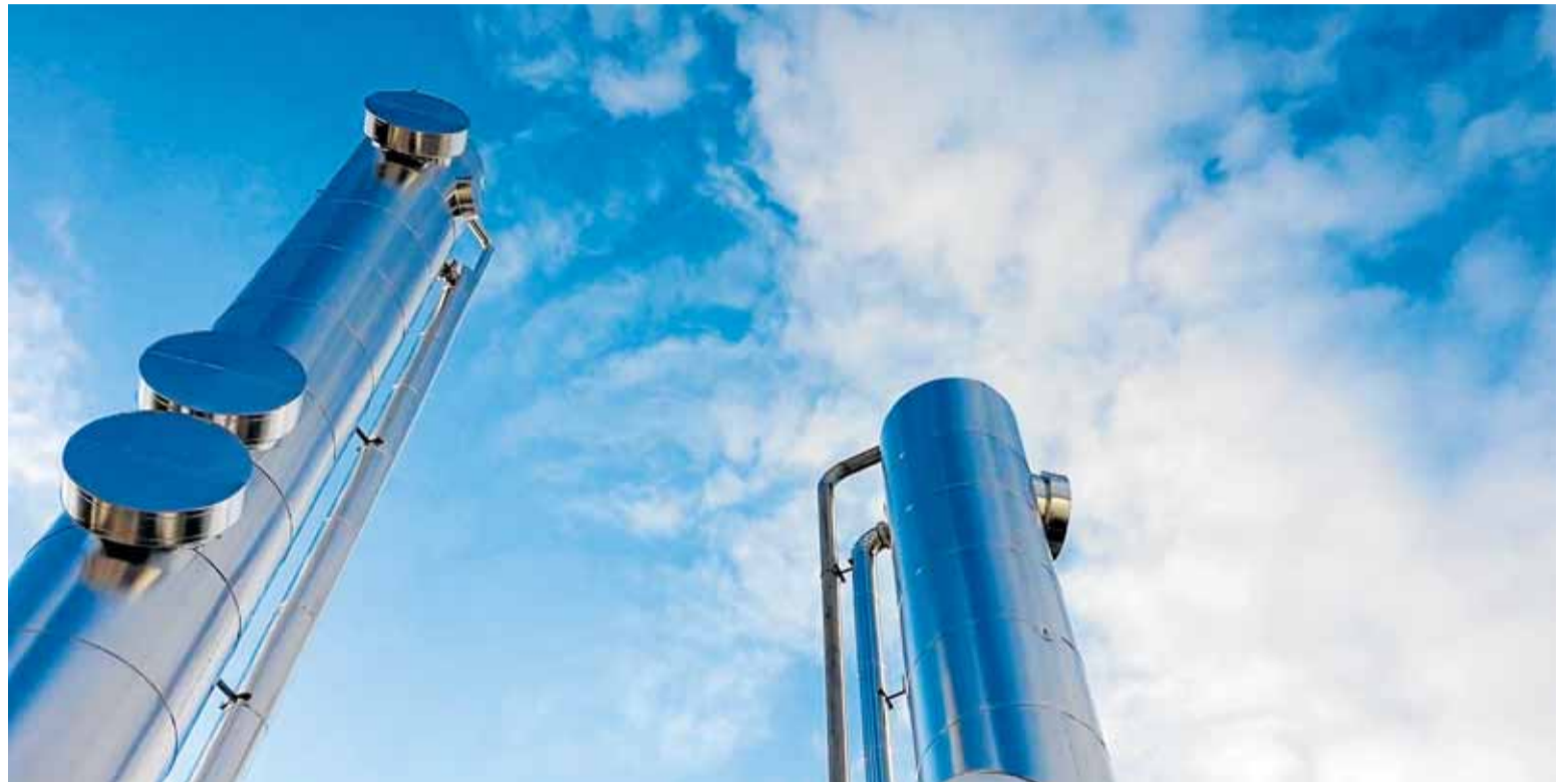
UNUE, planta de biometano en operación en Burgos. Enagás Renovable
