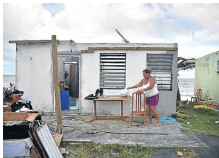
Una mujer observa los daños causados en su casa por 'María'. :: AFP
