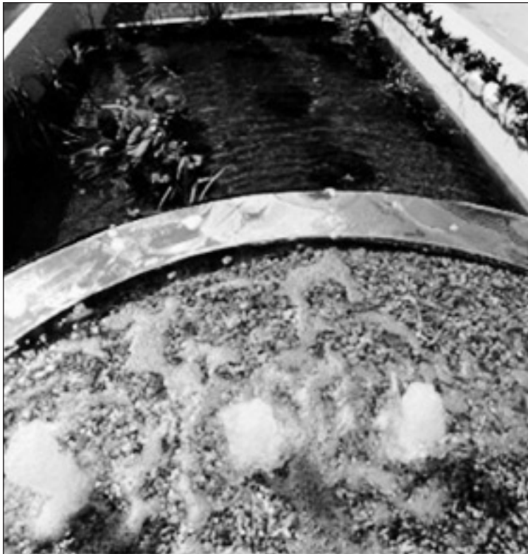
Vista parcial superior de una planta depuradora.
