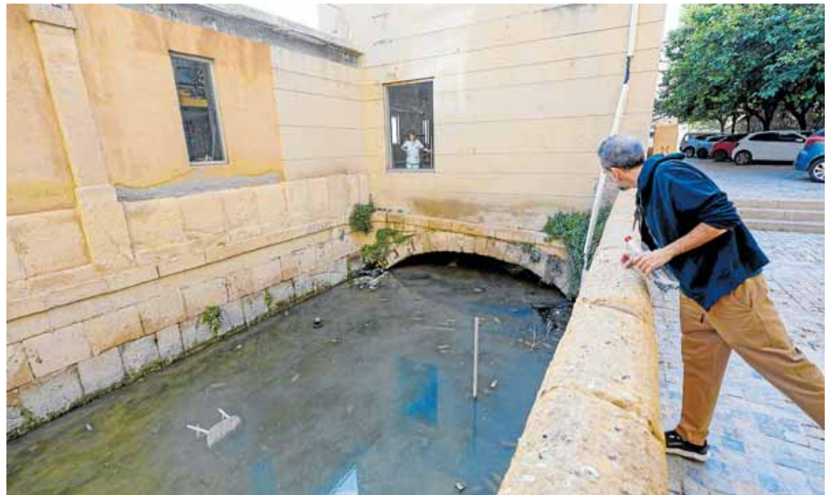
El lodo se acumula en el canal interior de los Molinos del Río junto a basura y enseres como sillas. NACHO GARCÍA
