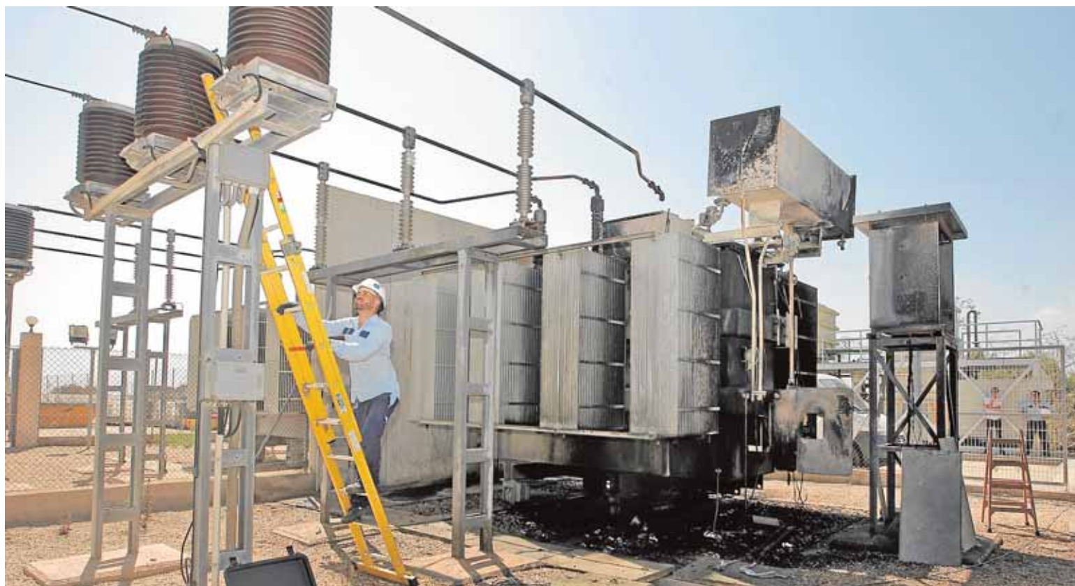
Un técnico examinó ayer los desperfectos en la estación transformadora de la desaladora San Pedro del Pinatar II. ■ PEDRO MARTÍNEZ
