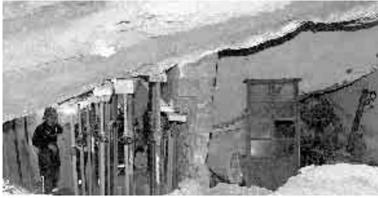
Los bomberos apuntalan la zona más peligrosa. / S. M. LARIO / AGM
