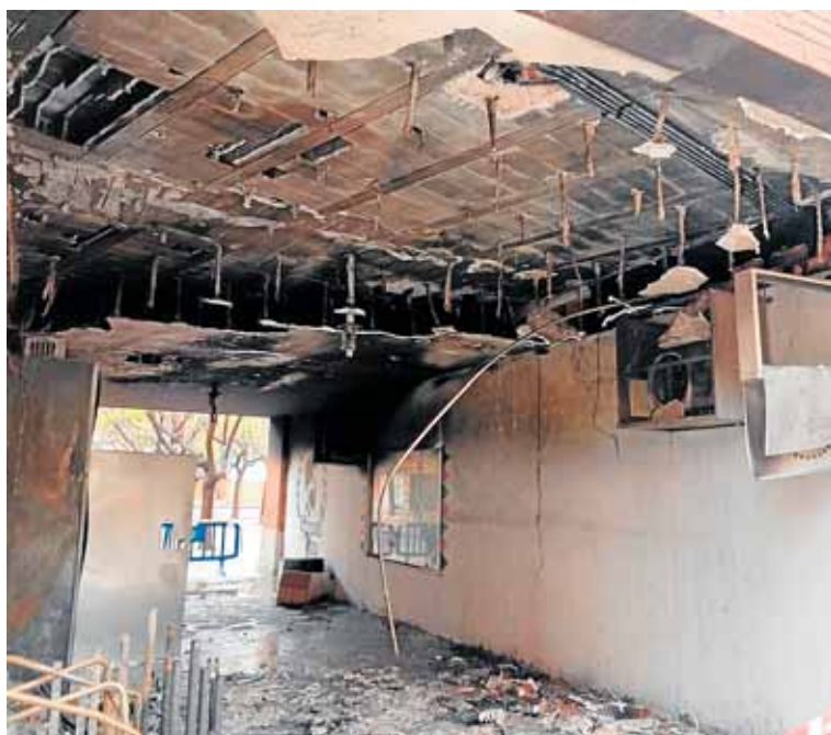
Zona exterior del local totalmente calcinado tras el incendio. LA VERDAD
