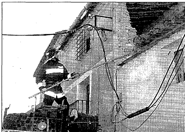
Estado en que quedó una de las casas afectadas por el terremoto de febrero. G. C.
