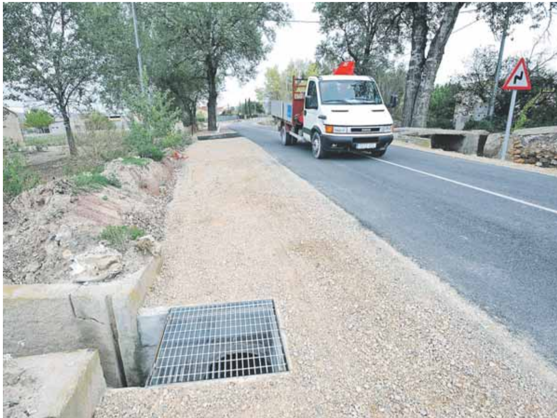
La carretera de Lorca a La Almenara, cuya mejora acaba de finalizar. :: PACO ALONSO / AGM
