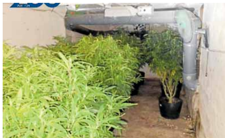
Plantas de marihuana ocultas en una de las cámaras de aire de un edificio. CNP
