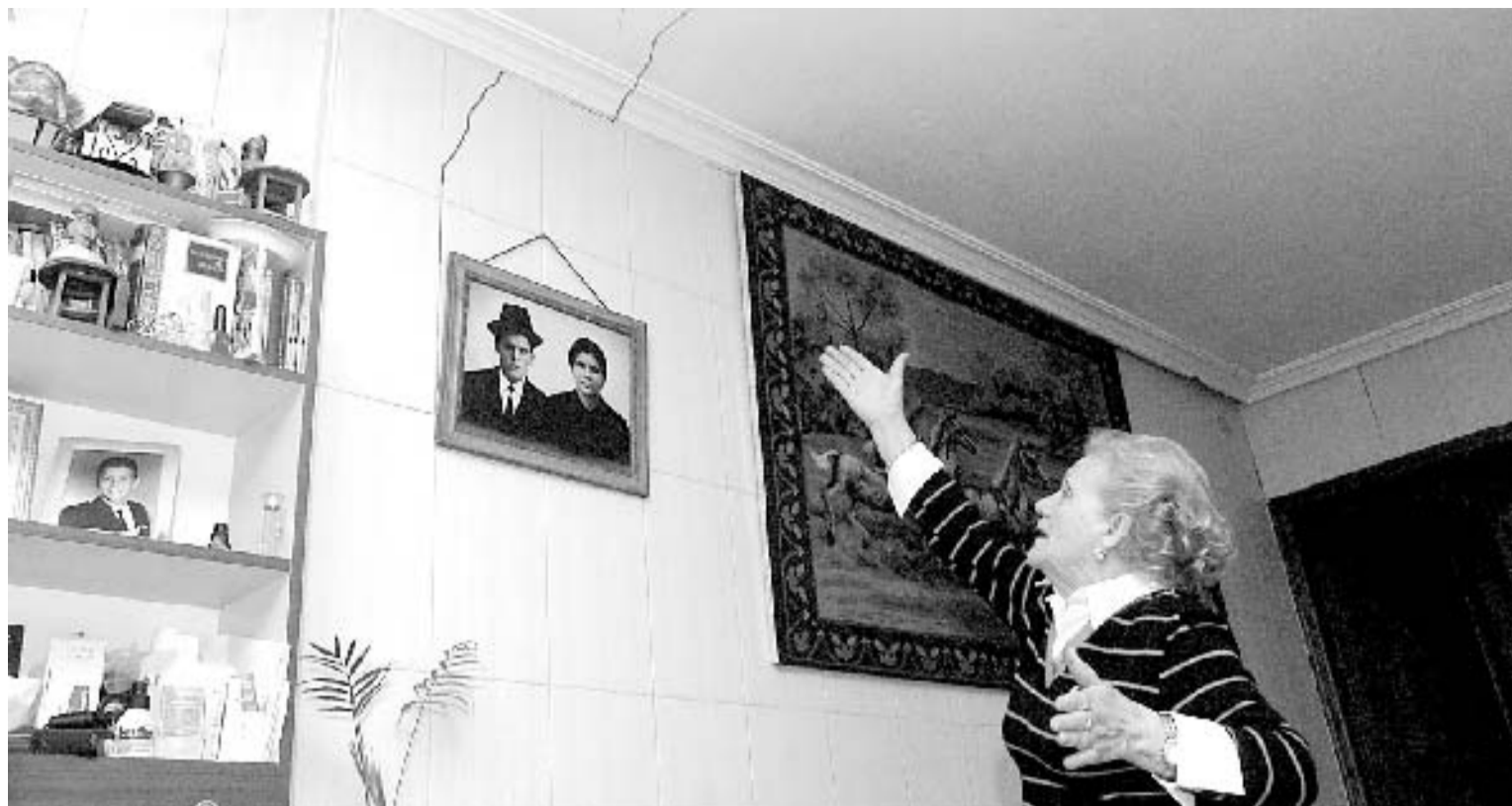
MIEDO. Una vecina muestra las grietas en una de las paredes de su casa en Rincón de Seca. / JAVIER CARRIÓN / AGM
