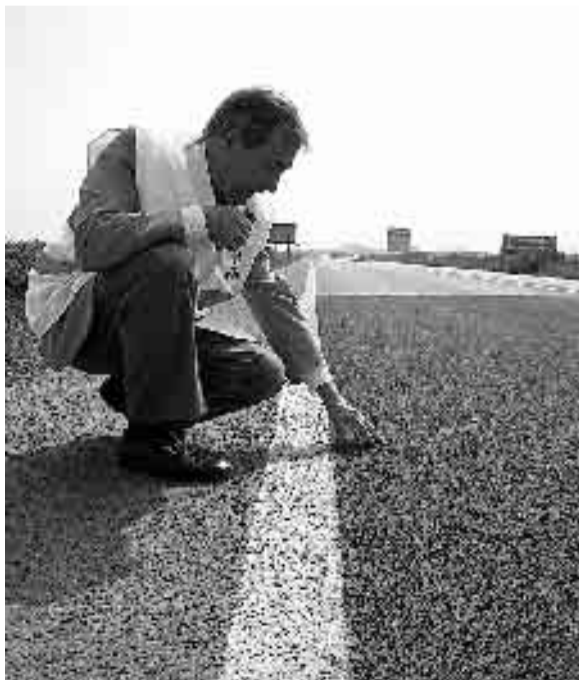
El director general de Carreteras, José Guijarro comprueba el estado del nuevo firme. / CARM
