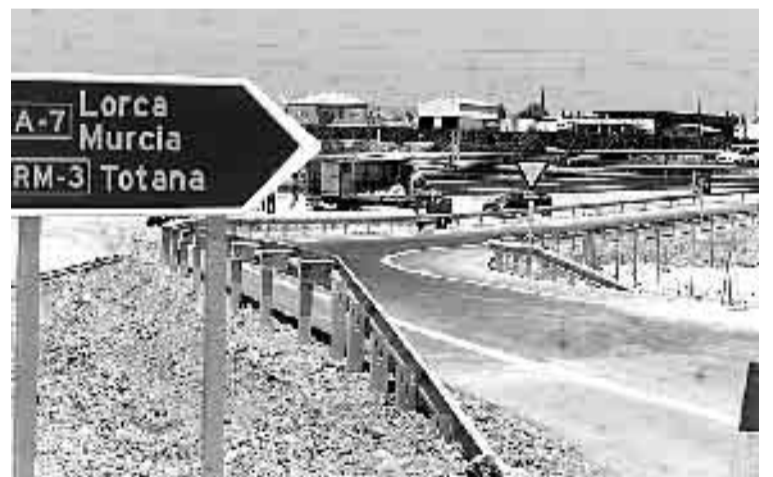
SEGURIDAD. Los guardarraíles sin protección. / J. CARRIÓN / AGM
