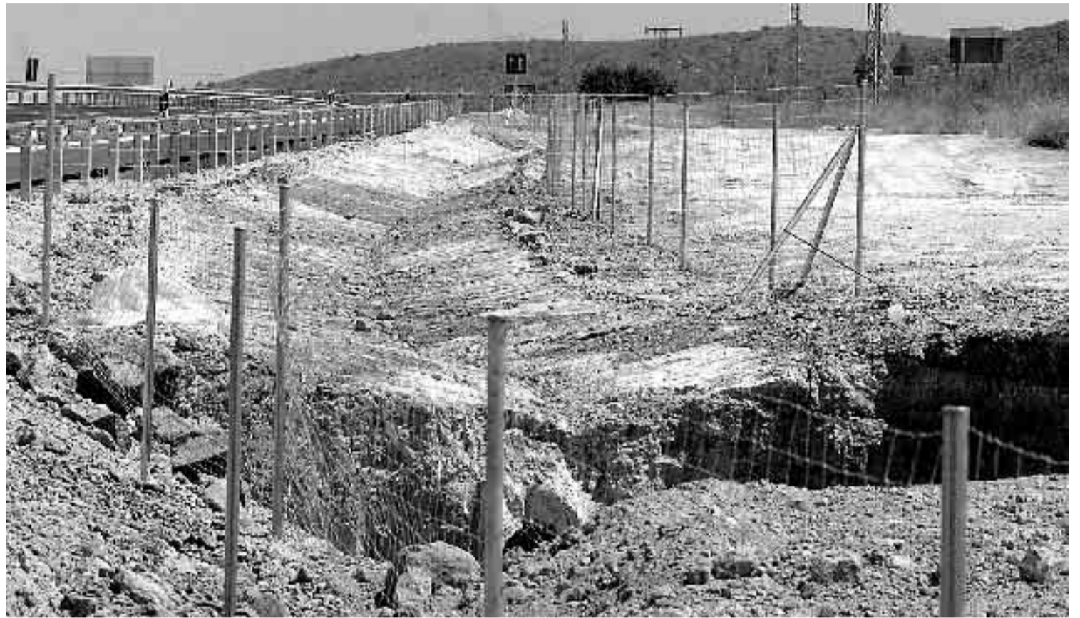
SIN TERMINAR. Algunos tramos tenían las zonas de desagüe de los arcenes a falta de hormigonarlos. / JAVIER CARRIÓN / AGM
