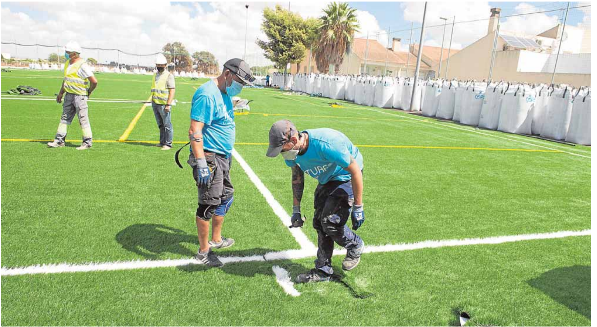
Varios trabajadores, ultimando ayer los detalles del recién instalado césped artificial, en el campo de fútbol de El Bohío. ANTONIO GIL / AGM
