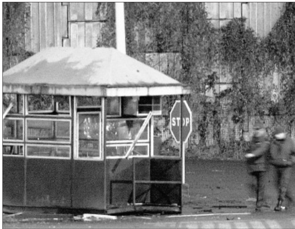
Dos guardias civiles observan los graves desperfectos causados en la garita tras la explosión.
