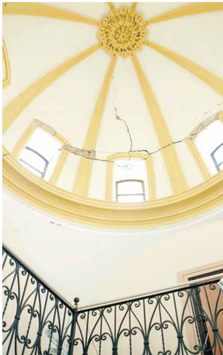
Grietas en la cúpula de la escalera del Conservatorio. ■ S. M. L. / AGM
