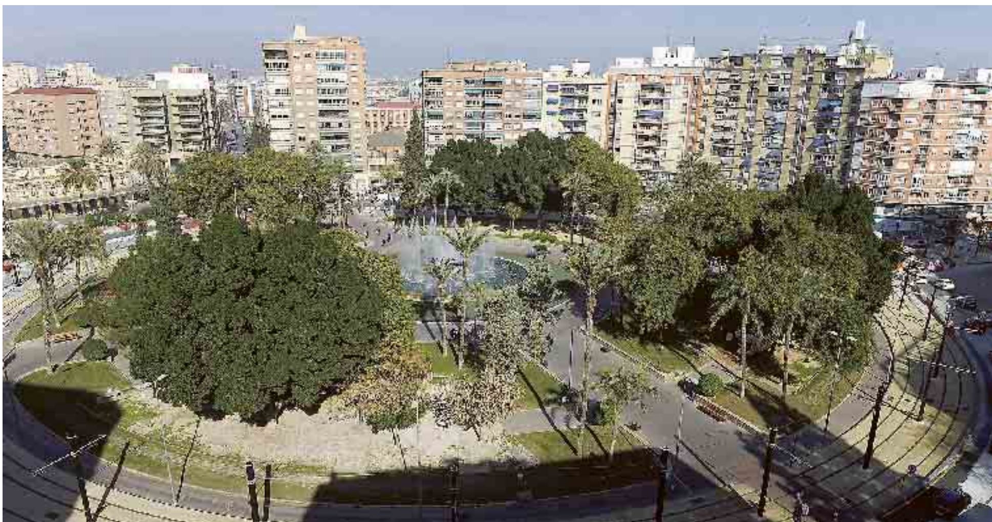
Aspecto de la Plaza Circular con las obras de adecuación del Tranvía prácticamente finalizadas. Nacho García
