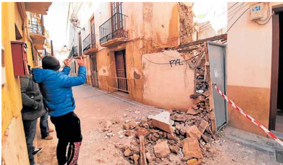
Elías Romero, ante los escombros de la casa que se derrumbó junto a la suya, en la calle Cava. INMA RUIZ
