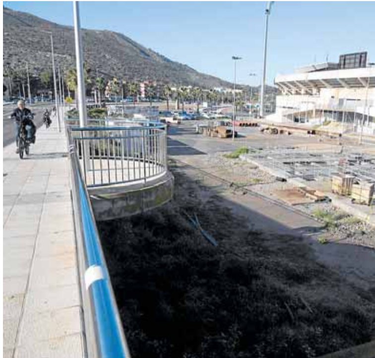
Las obras mantienen inútil parte del parking del estadio. ANTONIO GIL / AGM
