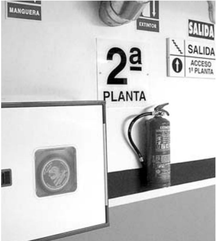
SEÑALIZADO. Emergencia y contraincendios, identificados. / A. H.
